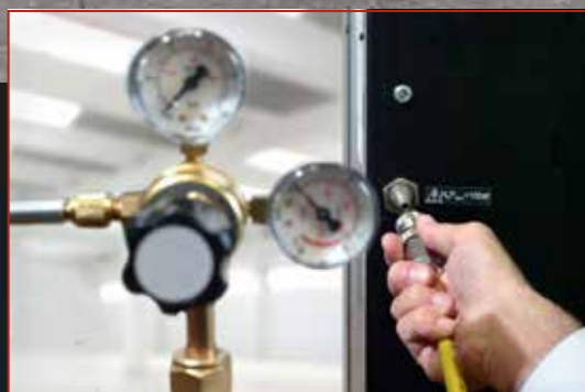
CONTROLLO PRESSIONI AD AZOTO
