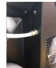
Ligação rápida para mangueira de descarga de CO 2
