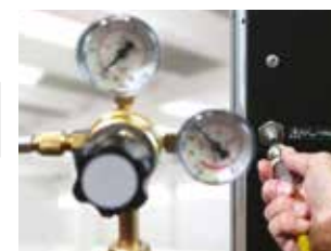
Controlo da pressão do azoto
